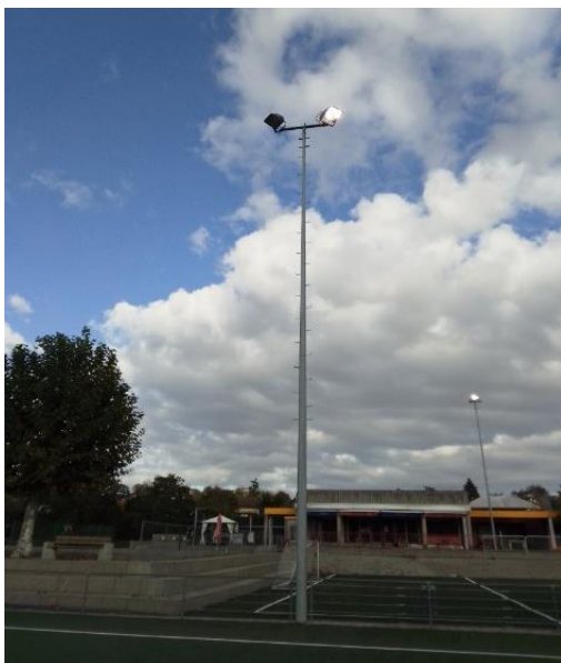
Luminaire B2 – Terrain B
