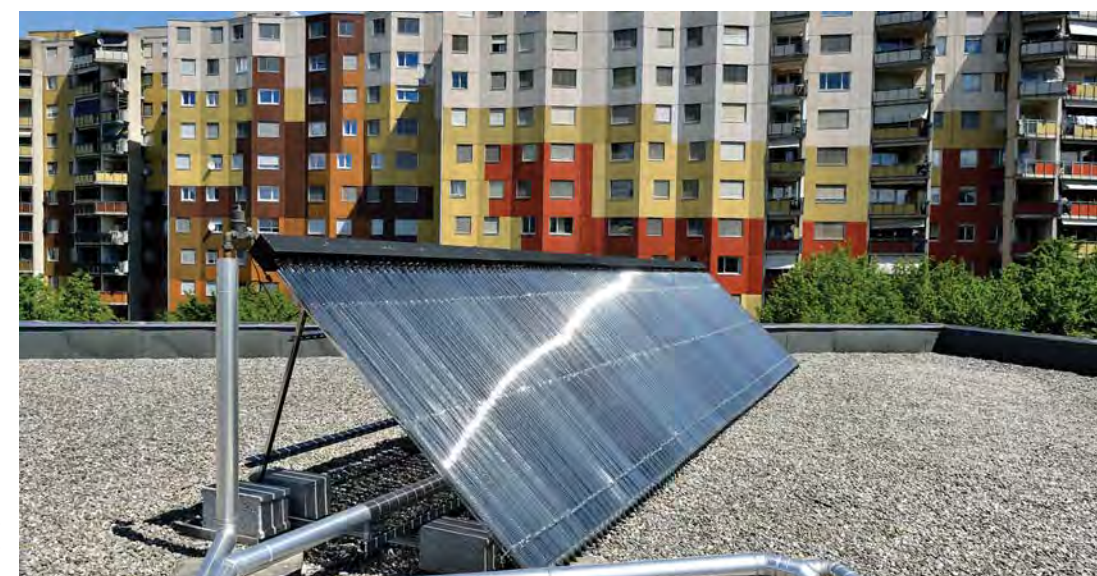
Panneaux photovoltaïques sur les toits de l'école d'Avanchet-Jura.
