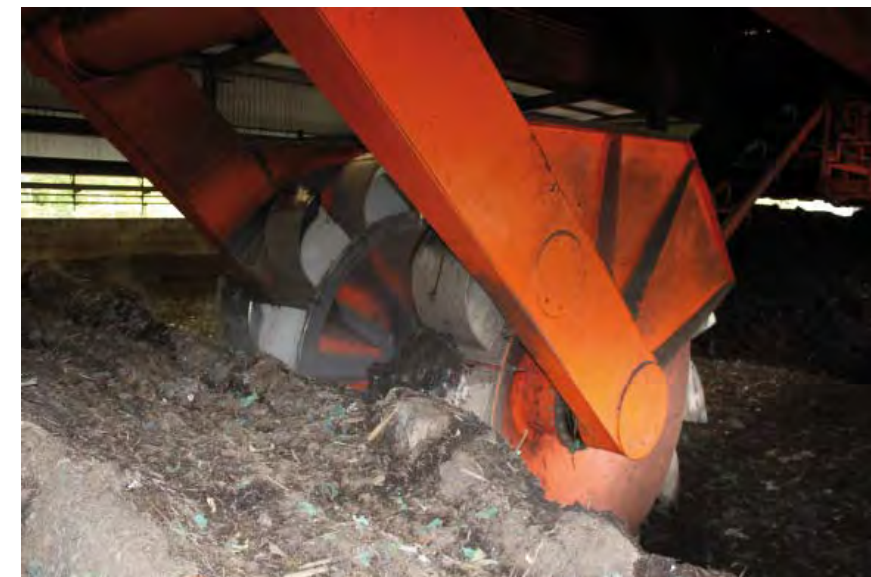
Roue qui brasse la matière en phase de compostage dans la grande halle du site.
