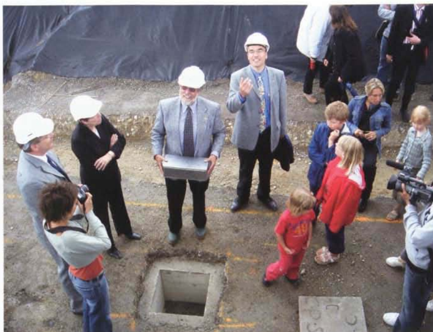
La première pierre de la nouvelle école a été posée le 29 mai dernier
